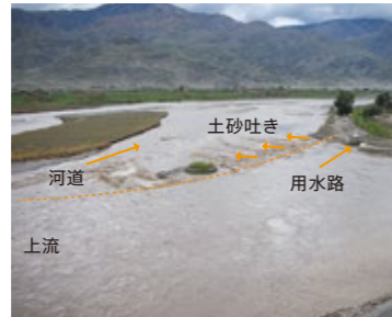
マルワリード堰 斜め堰をはじめ、伝統工法を参考にして実践した様々な工法をPMS方式としてまとめた
